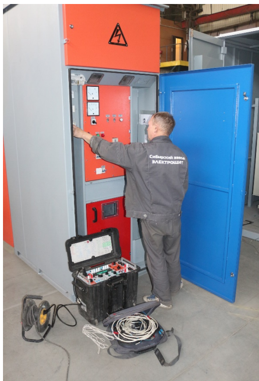
Рисунок 6 – Заводские испытания ячейки
